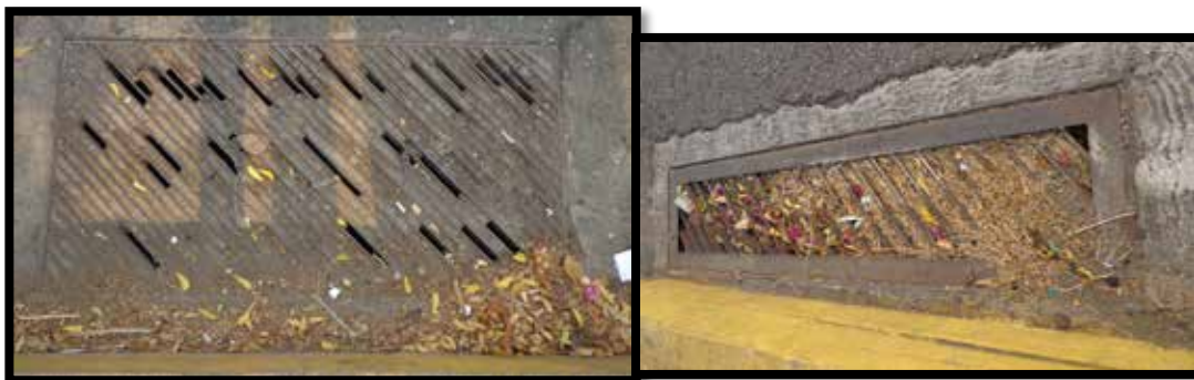
Figura 13. Sumidero de Rejilla Av. Don Julio Centeno
