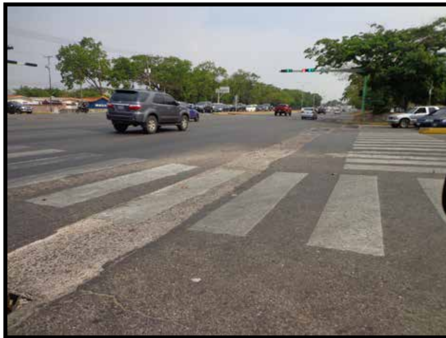
Figura 11. Daños Superficiales Av. Don Julio Centeno
