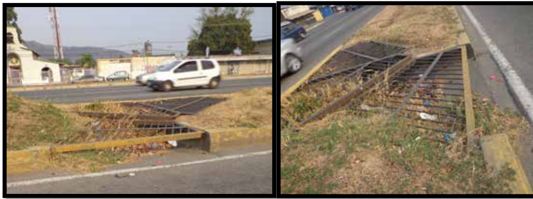
Figura 12. Sumidero de Ventana Av. Don Julio Centeno
