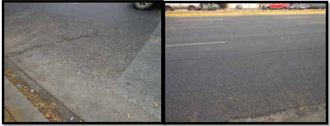
Figura 9. Fisuras Av. Don Julio Centeno
