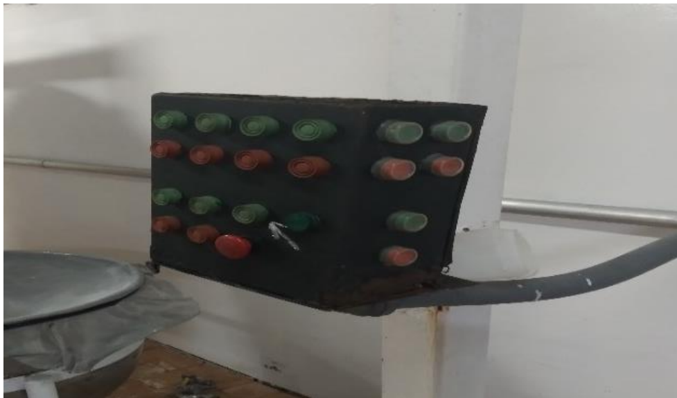
Figura 1. Tablero de control para el funcionamiento de la línea.
