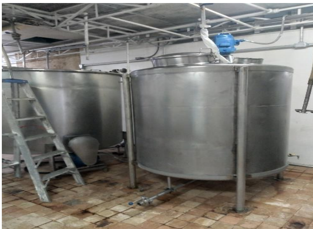
Figura 3. Tanques de almacenado y mezclado del producto A y B. Fuentes: Luis Natera (2022).
