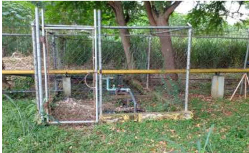
Figura 7. Tanque de campo T – 01
