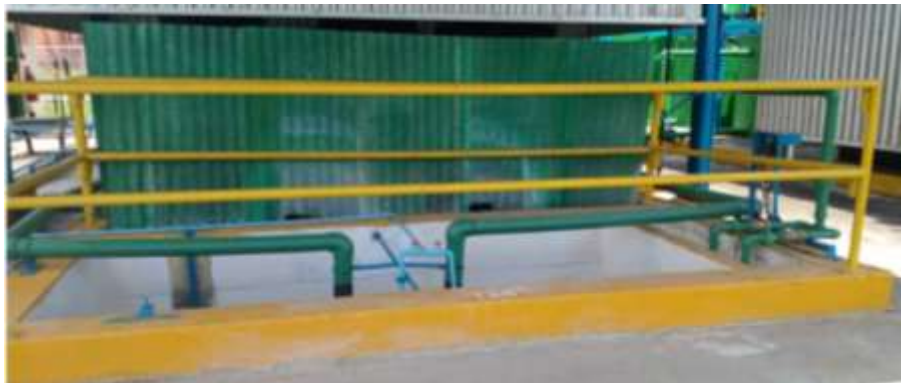
Figura 15. Tanquilla T – 14. Sedimentador secundario
