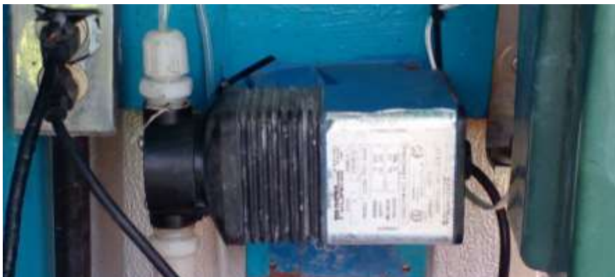
Bomba dosificadora de hipoclorito de sodio
