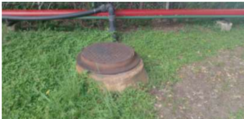
Figura 9. Tanque de campo T – 03
