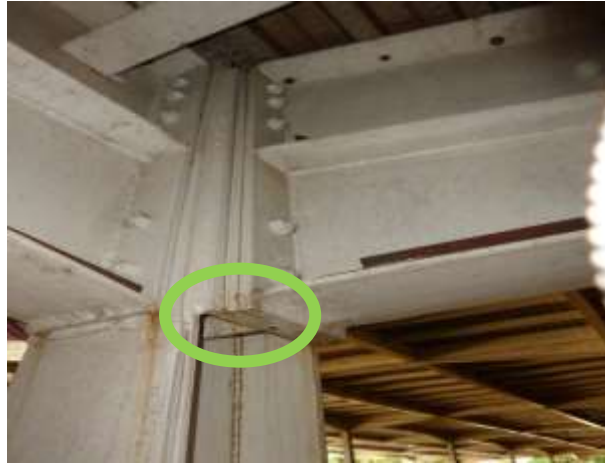
Figura 56 Ausencia de plancha de continuidad Fuente: Propia
