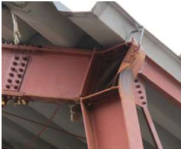
Figura 9. Deformación del panel nodal por acción del sismo
