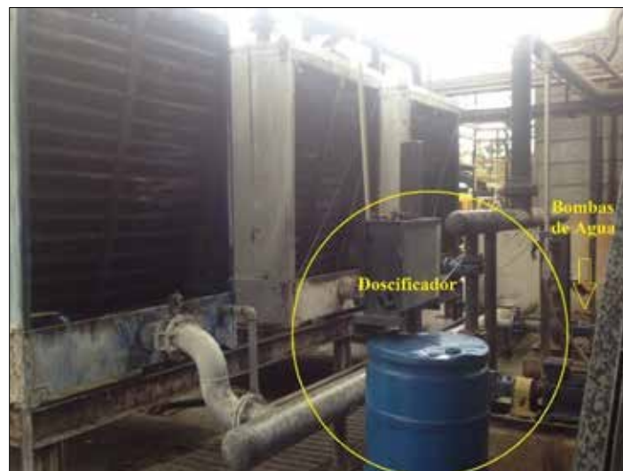
Imagen 2 Torres de enfriamiento del proceso (Bombas y Dosificador)
