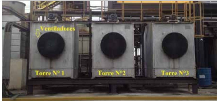
Imagen 1 Torres de enfriamiento del proceso
