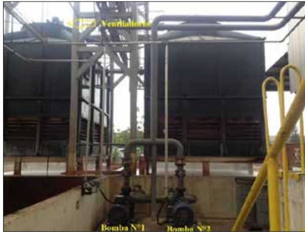
Imagen 4 Torres de enfriamiento del sistema de vacío (Conexiones)
