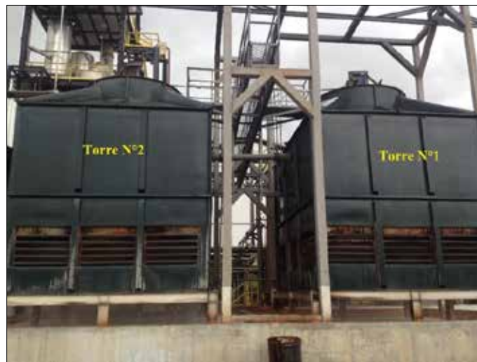
Imagen 3 Torres de enfriamiento del sistema de vacío
