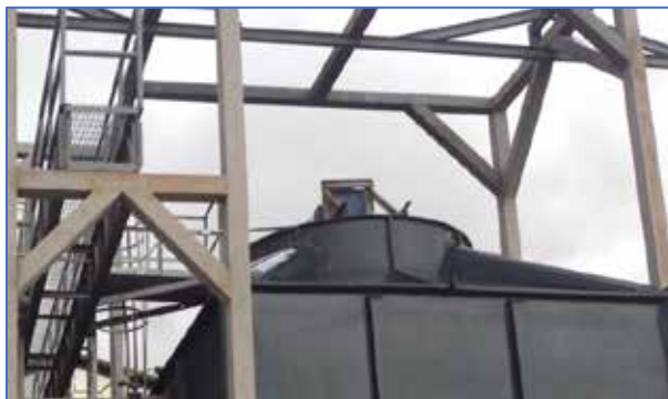
Imagen 5 Ventilador de torre de enfriamiento del sistema de vacío
