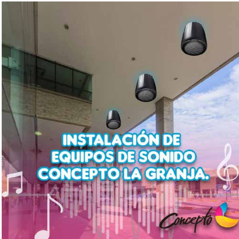
Figura N°1: Instalación de nuevos equipos de sonido de alta calidad en Concepto La Granja.
