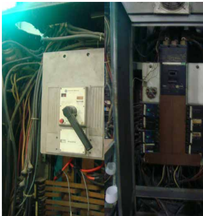
Figura 28. Tablero N. 1 (lado izquierdo) y Tablero N. 2 (lado derecho).
