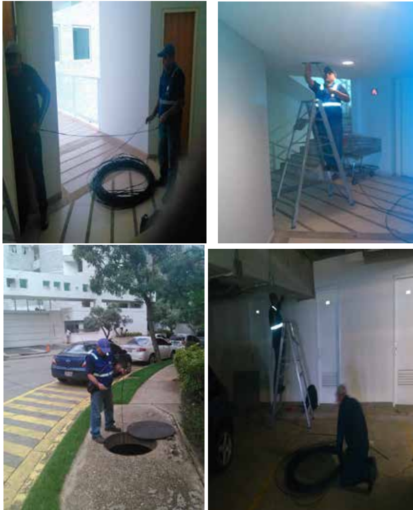
Figura 49. Acometida en Edif. Casablanca en Terrazas de Guataparo Fuente: Piñango. J. (2020)
