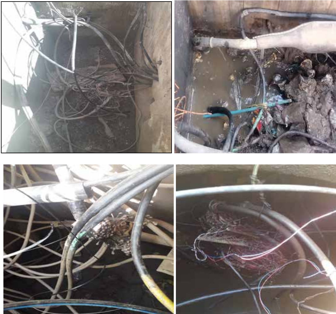
Figura 18. Visualización del deterioro en el cableado. Fuente: Piñango. J. (2020)
