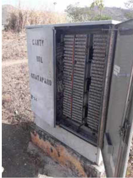
Figura 19. Visualización del deterioro en los armarios. Fuente: Piñango. J. (2020)
