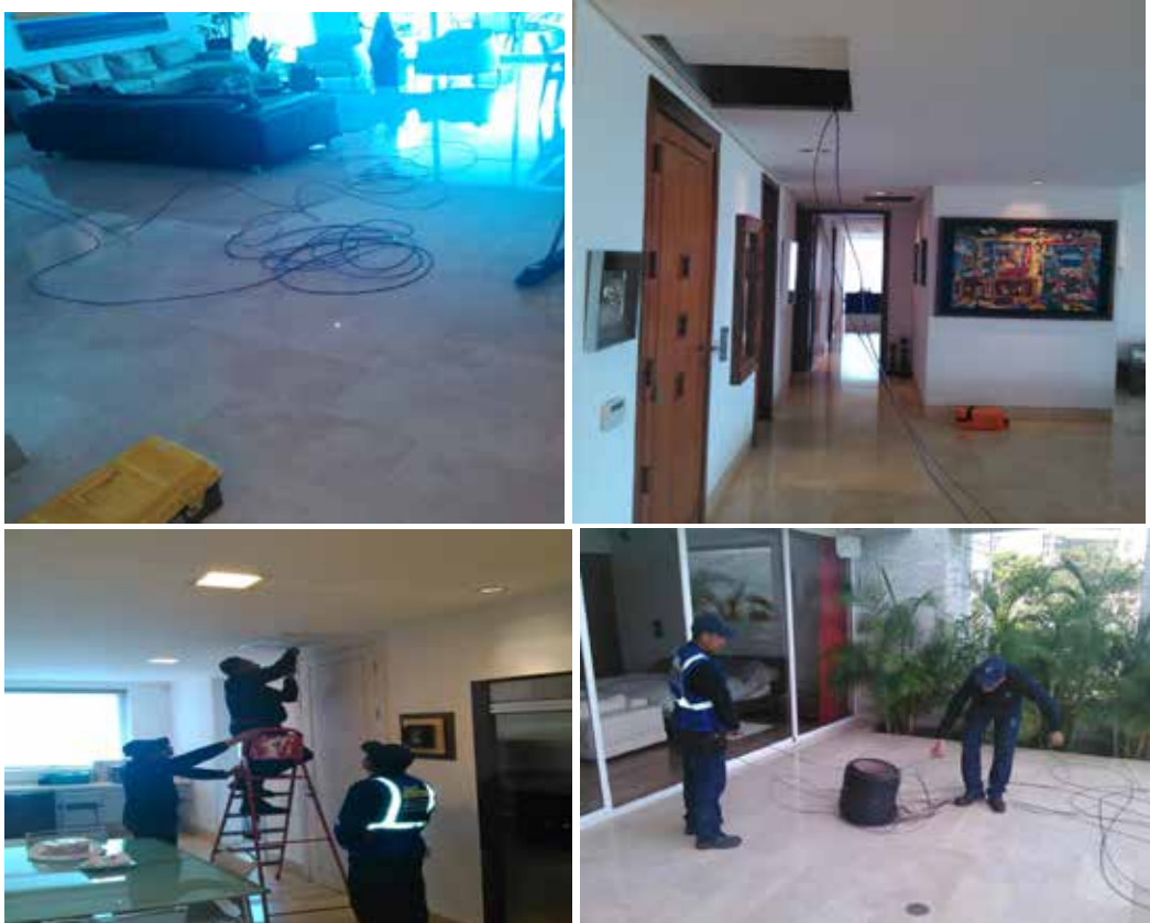
Figura 57. Acometida en apartamento de cliente en residencia Casablanca Fuente: Piñango. J. (2020)
