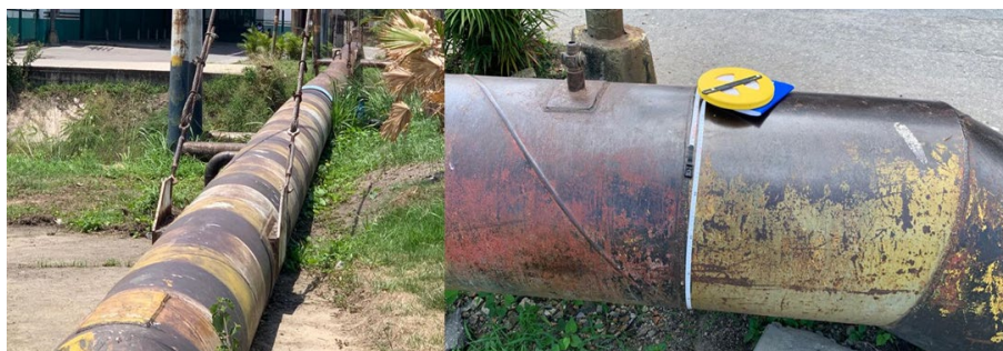
Figura 9: Imágenes de la tubería principal de suministro de aguas blancas de la ciudad.
