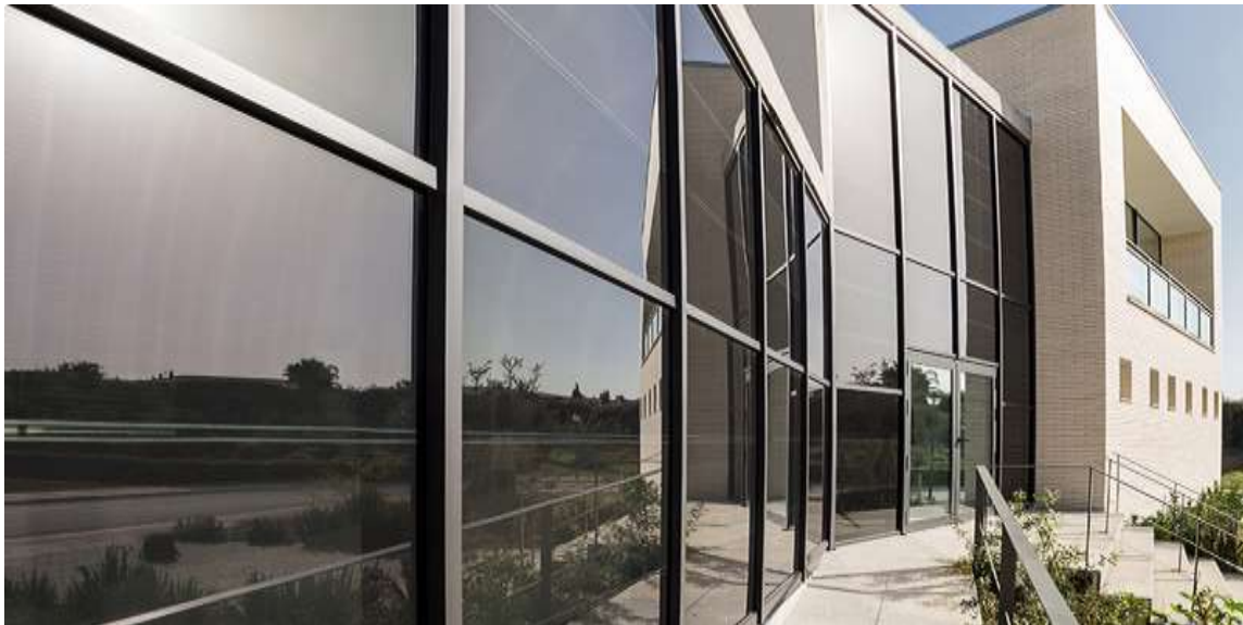
Figura 61. Fachada de Muro Cortina de paneles de Vidrio Fotovoltaico.
