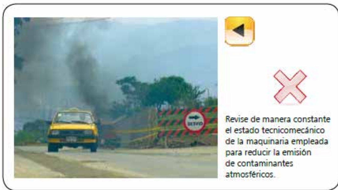
Figura 12. Control de emisión de gases tóxicos de maquinaria.
