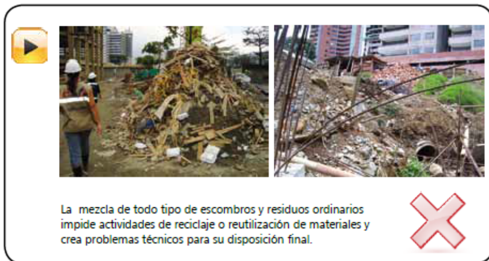
Figura 9. Escombros dispuestos de manera inadecuada.
