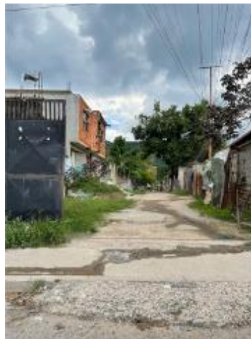
Figura 5: Evidencia fotográfica de las aceras del sector Bárbula
