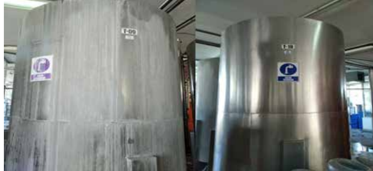
Figura 9. Tanques de Almacenamiento de Agua Tratada, T-09, T-10
