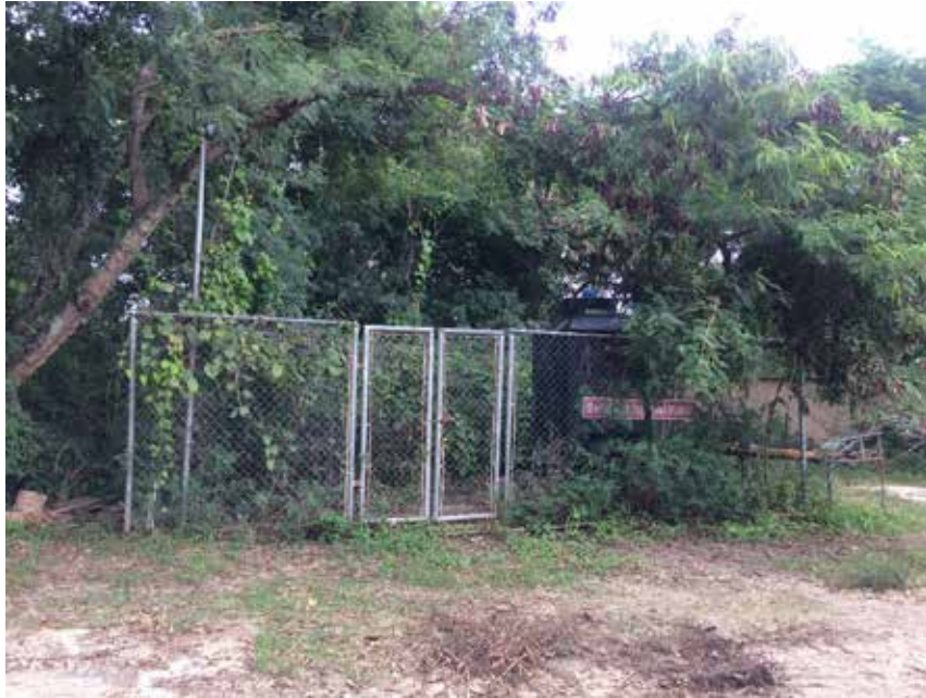
Figura 35. Estado actual de la torre de enfriamiento.
