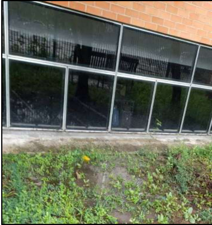
Figura 2. Sótano que se inunda. Edificio 4 Fuente: Contreras y Páez (2022)
