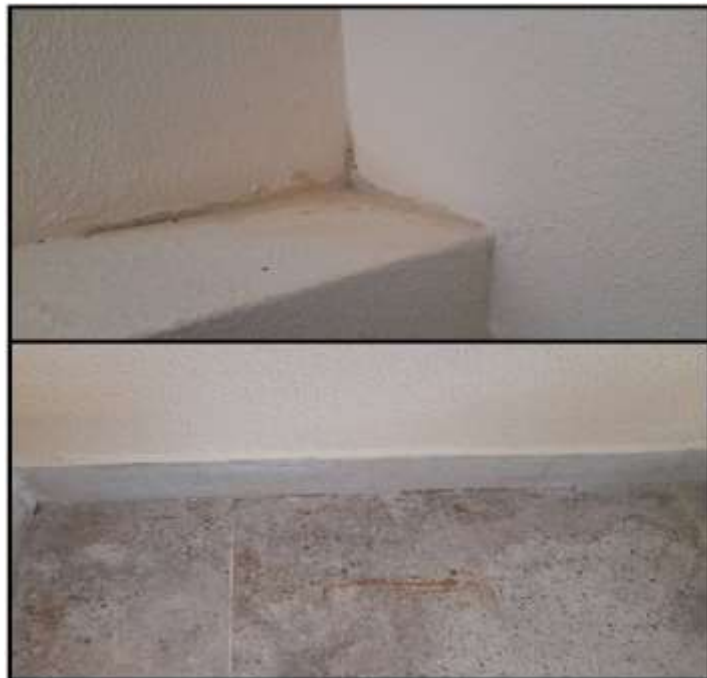
Figura 3. Deterioro en pisos y paredes Fuente: Contreras y Páez (2022)
