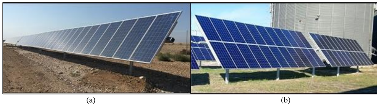
Figura 13: Seguidores solares horizontales con configuración 1P (a) y 2P (b)
