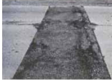
Figura 55. Foto10. Parches de concreto -PCHC (Fuente: Y. Apóstol, (2019))
