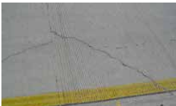
Fig.46 Foto 1. Grieta esquina- (Fuente: Y. Apóstol, (2019))
