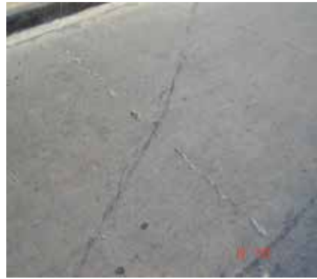
Fig 49. Foto 4. Grietas extremos de los pasadores- (Fuente: Y. Apóstol, (2019))
