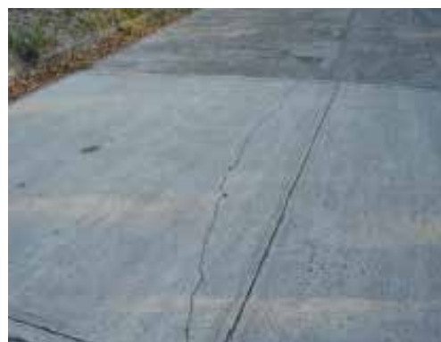
Figura 47. Foto 2. Grieta longitudinal – GL (Fuente: Y. Apóstol, (2019))
