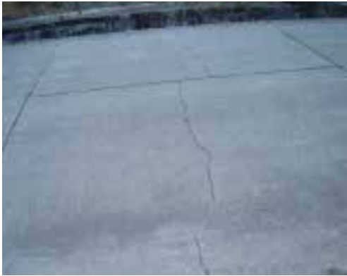
Fig 48. Foto 3. Grieta transversal-GT (Fuente: Y. Apóstol, (2019))
