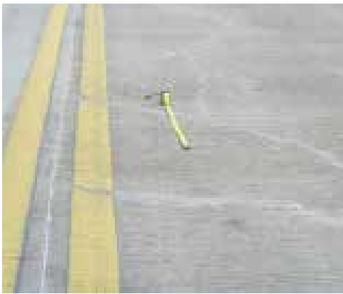
Fig 50. Foto5. Grieta en bloque- GB (Fuente: Y. Apóstol, (2019))
