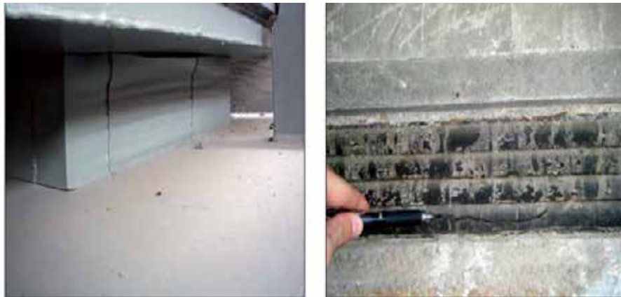
Figura 32 Rotura en el Aparato de apoyo.
