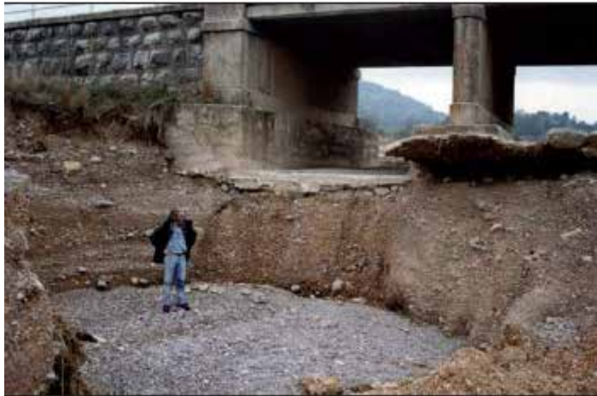
Figura 23 Socavación en Pilas. Fuente: Ministerio de Fomento, España, 2012
