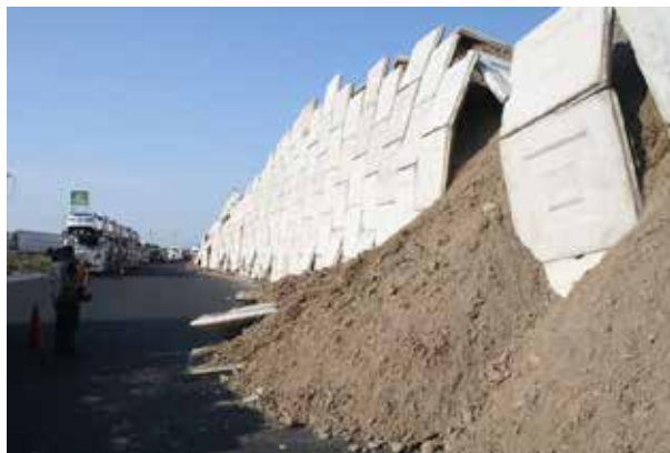
Figura 26 Colapso muro de contención.
