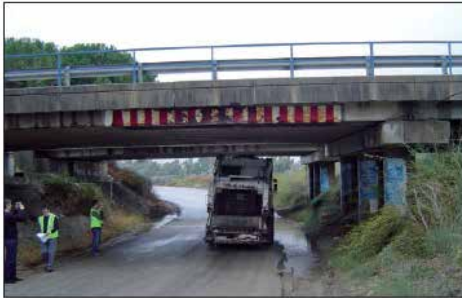
Figura 22 Estructura con Problemas de Gálibo.
