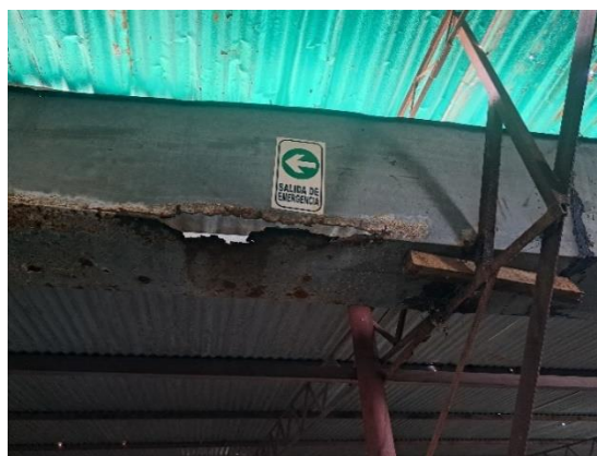
Figura 16. Deterioro en los canales de lluvia Autor: Barakat y Gallego (2022)
