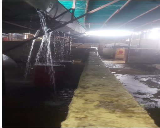
Figura 6. Deterioro en los canales de lluvia Autor: Barakat y Gallego (2022)
