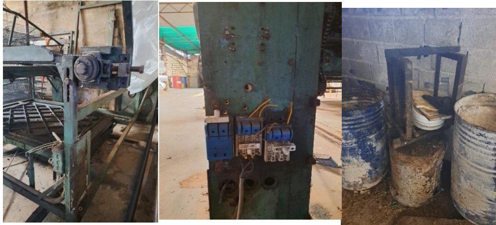
Figura 19. Máquinas y equipos no operativos Autor: Barakat y Gallego (2022)
