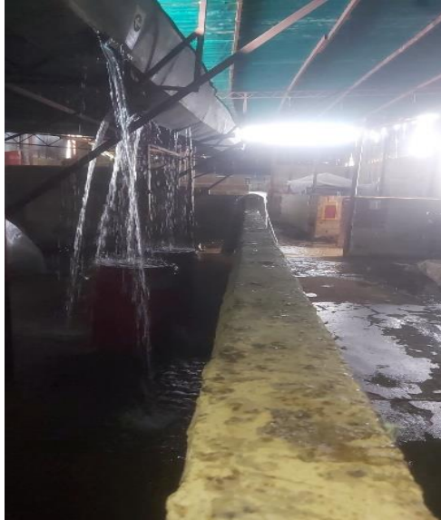
Figura 2. Deterioro en los canales de lluvia
