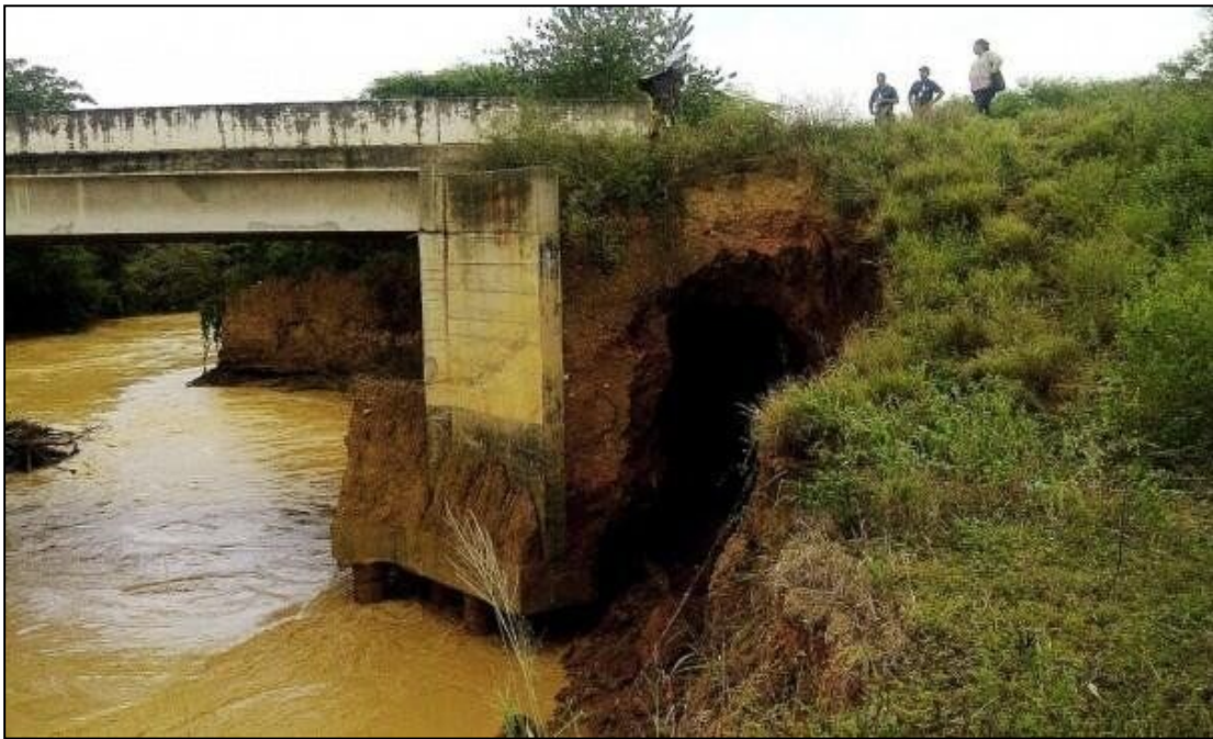
Figura 12: Socavación en aleta de entrada de un puente.
