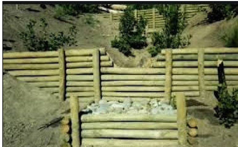
Figura 21: Dique de postes impregnados y sacos de tierra.
