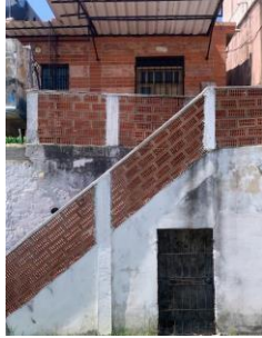
Figura 10. Estado de las viviendas existentes.
