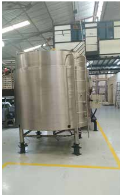
Figura 6. Tanque de Tratamiento Térmico
