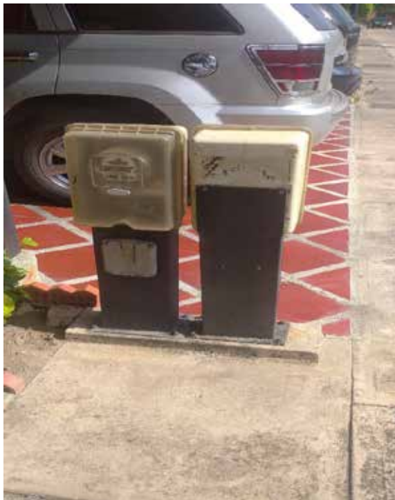
Figura 28. Medidor Principal de electricidad. Marin A, Rojas G (2020)
