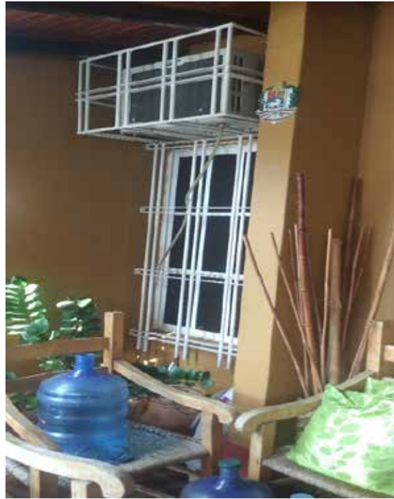
Figura 32. Ventana y aire acondicionado, vista frente. Marin A, Rojas G (2020)
