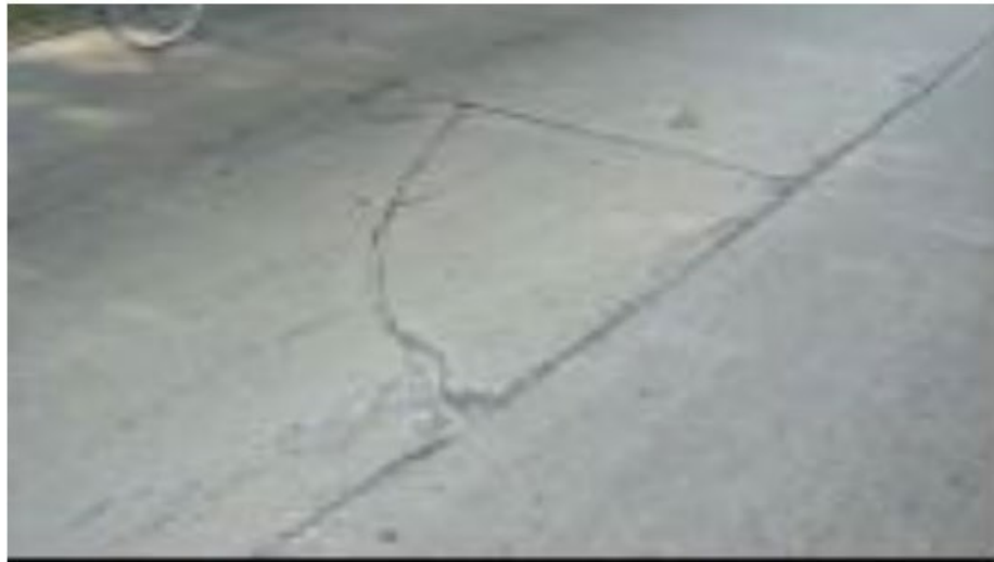
Figura 16. Grietas de esquina en el Pavimento Rígido
