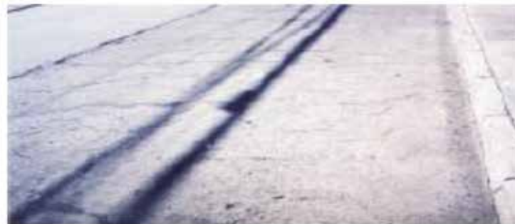
Figura 19. Fisuramiento por retracción en el pavimento rígido
