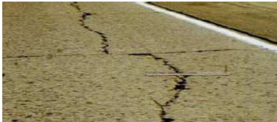
Figura 17. Grietas Longitudinales en el pavimento rígido
