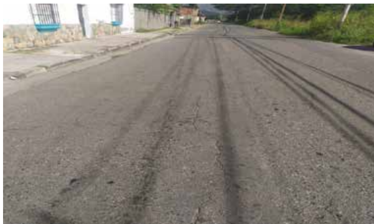
Figura 77: Falla Longitudinal en la calle Páez.
