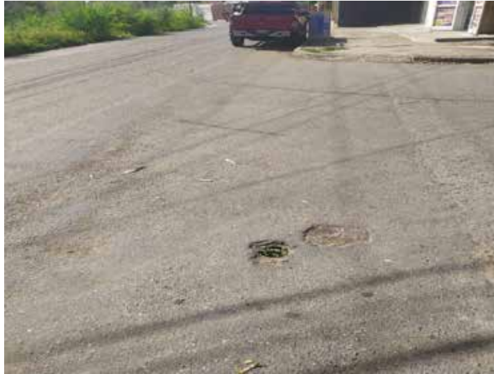
Figura 78: Hundimiento en la calle Paez.
