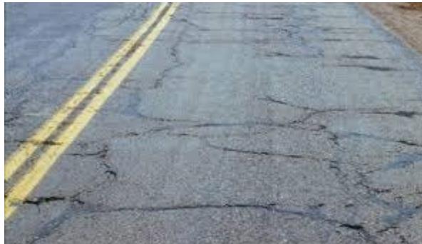
Figura 10: Fisura del pavimento flexible
