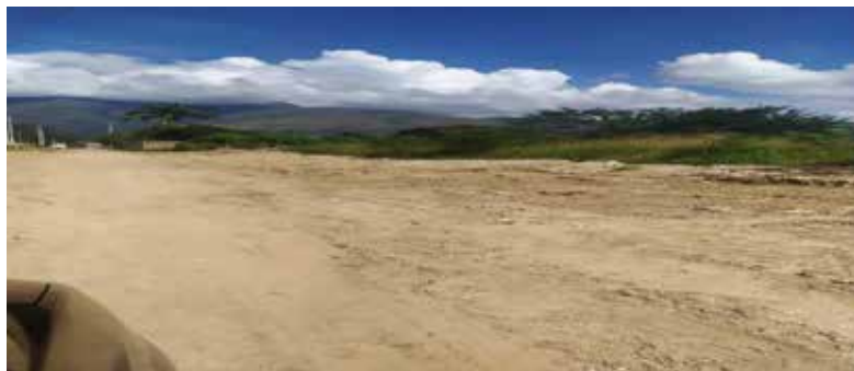
Figura 75: Pérdida del agregado en la calle Páez.
