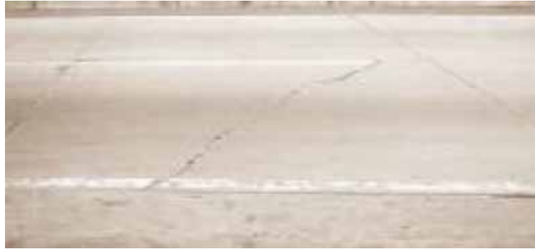
Figura 18. Grietas Transversales en el pavimento rígido
