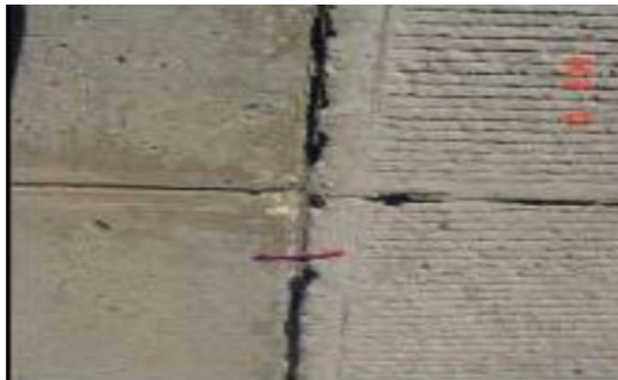
Figura 13. Deficiencias del Sellado en el Pavimento Rígido
