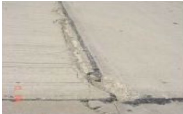
Figura 14. Juntas Saltadas en el Pavimento Rígido
