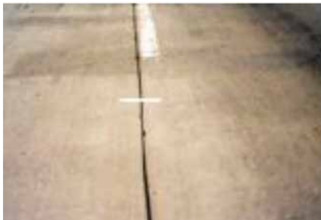
Figura 15. Separación Longitudinal de la junta en el Pavimento Rígido
