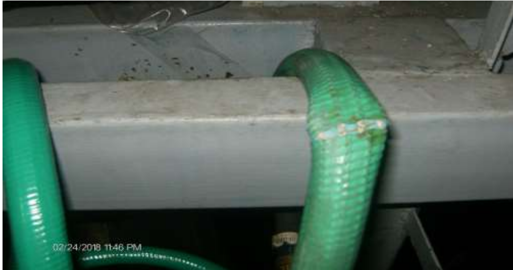
Figura 6. Deterioro en el sistema de llenado
