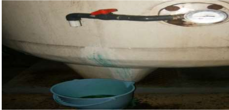
Figura 4. Bote de producto terminado en el reactor
