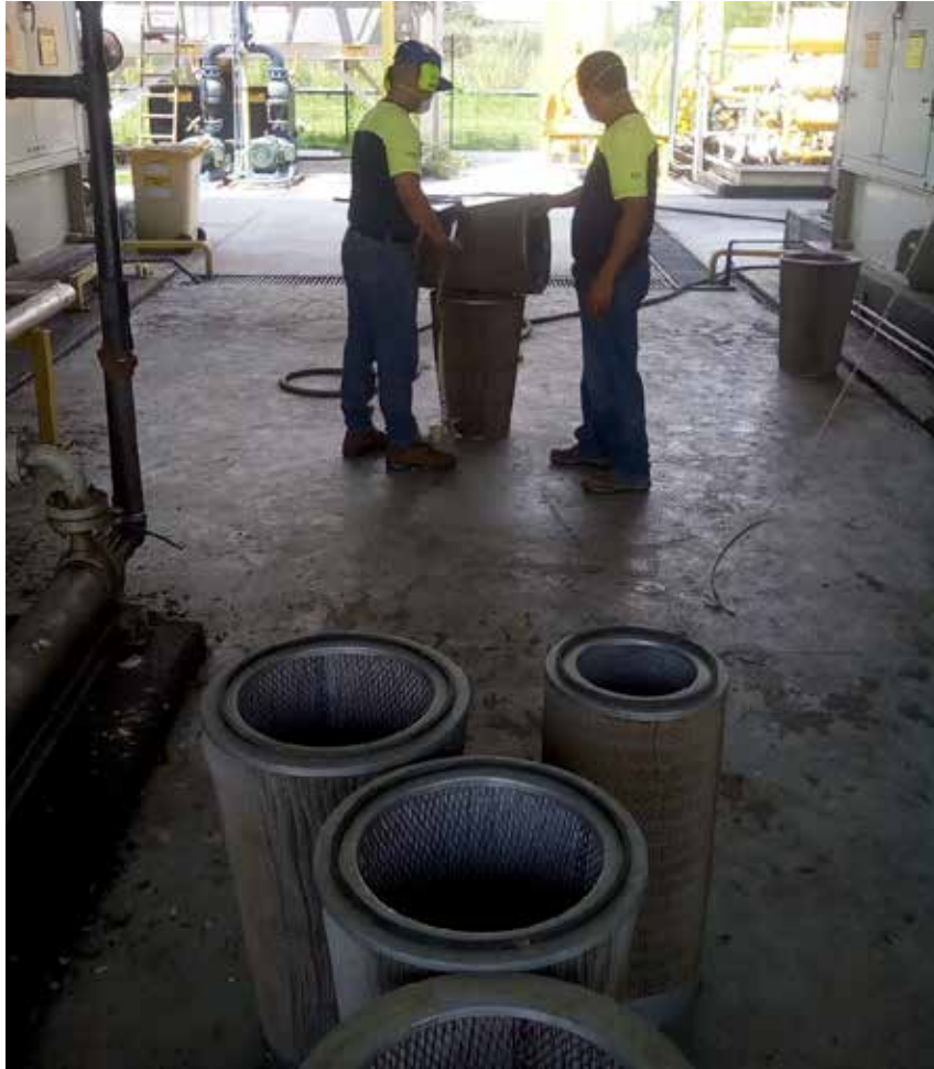
Figura 9. Limpieza filtros de admisión de aire del turbogenerador.
