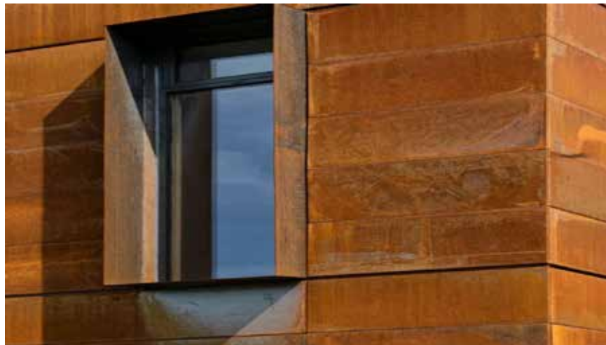
Figura 34 .Revestimiento Láminas Oxidadas. Fuente: Depositphotos (2021)
