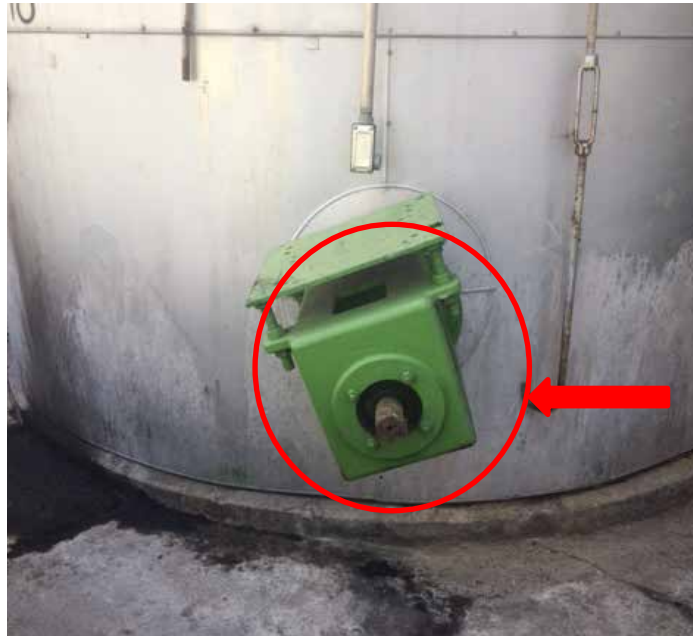
Figura 25: Tanque ausente de agitador
