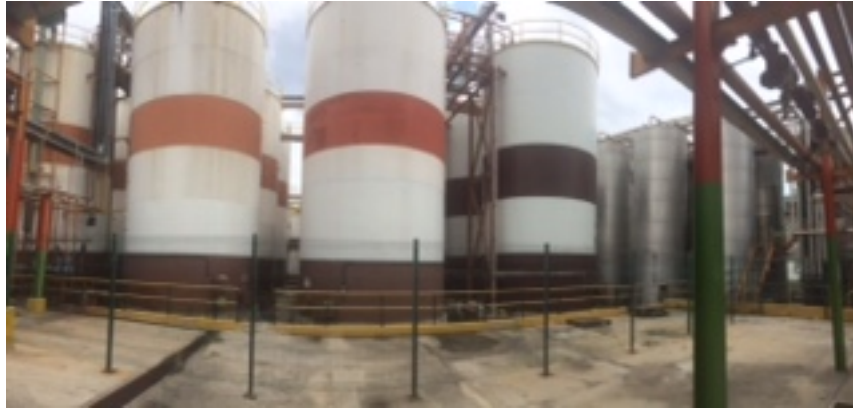
Figura 21: Área tanquería PT
