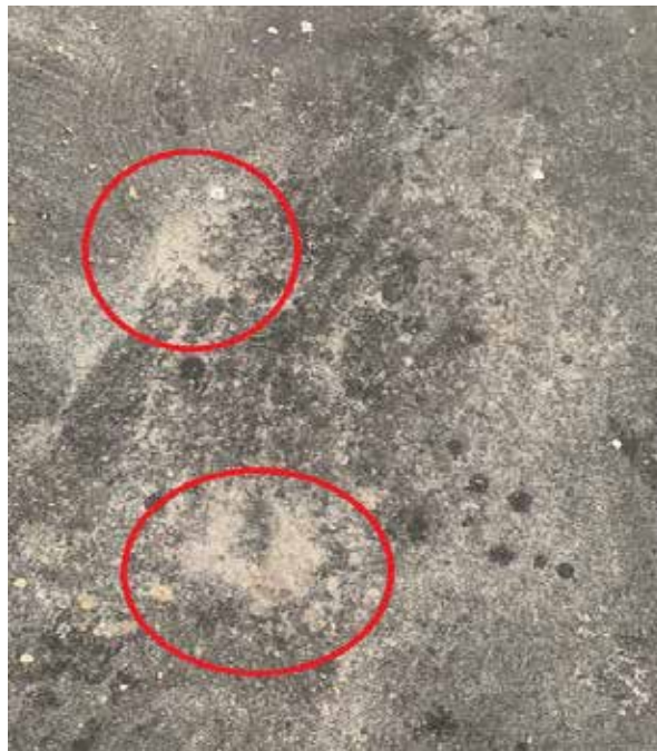
Figura 25. Mezcla pastosa que se forma al caer agua al piso Fuente: Tequeñería El Tequeñon C.A. Aporte: Di Modugno (2021)
