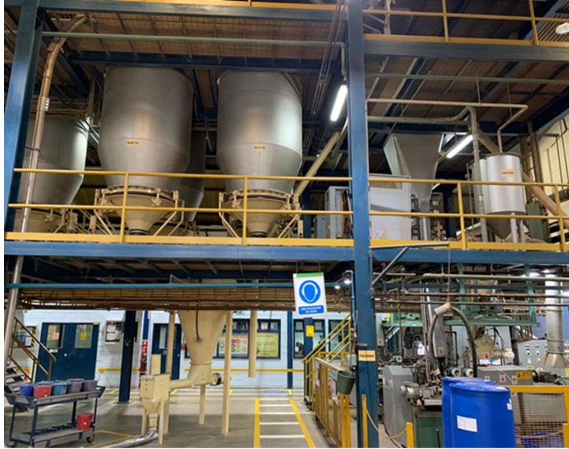
Figura 8: Línea 2 del área de producción de Planta Deer, Valencia. Autores: Arias, Gamboa (2023)
