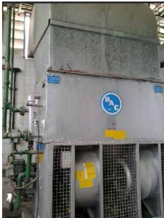
Figura N°14: Chiller. Fuente: INDUELCAR
