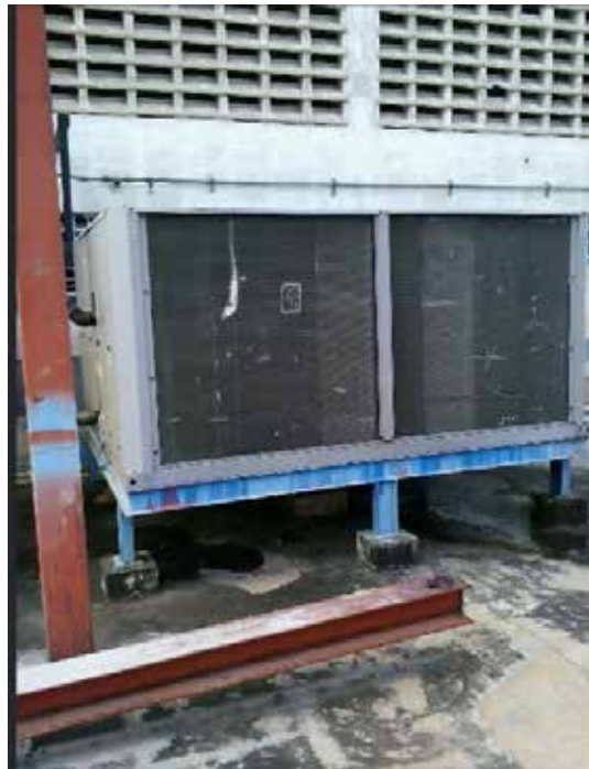
Figura N°16: Chiller tipo carrier. Fuente: INDUELCAR
