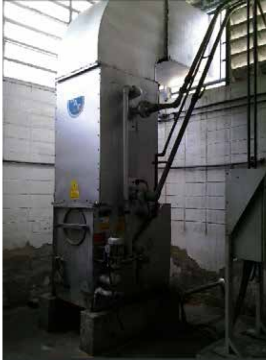
Figura N°15: Chiller. Fuente: INDUELCAR
