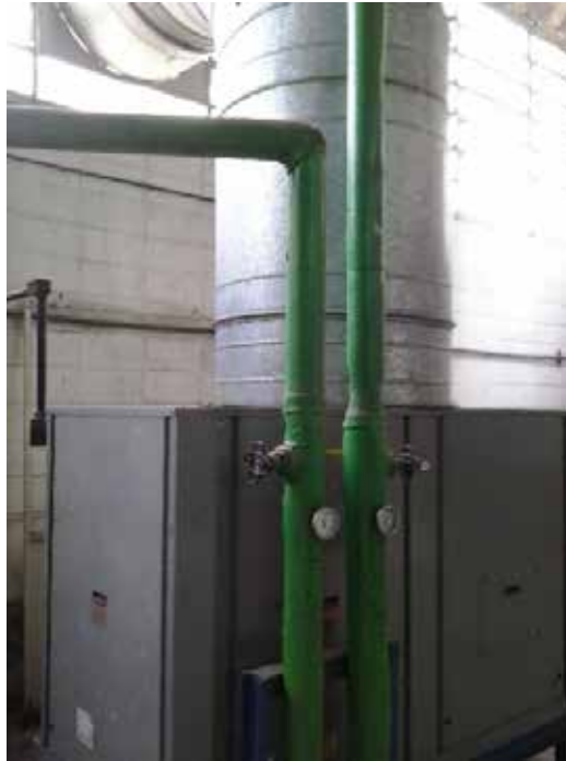
Figura N°13: Chiller. Fuente: INDUELCAR
