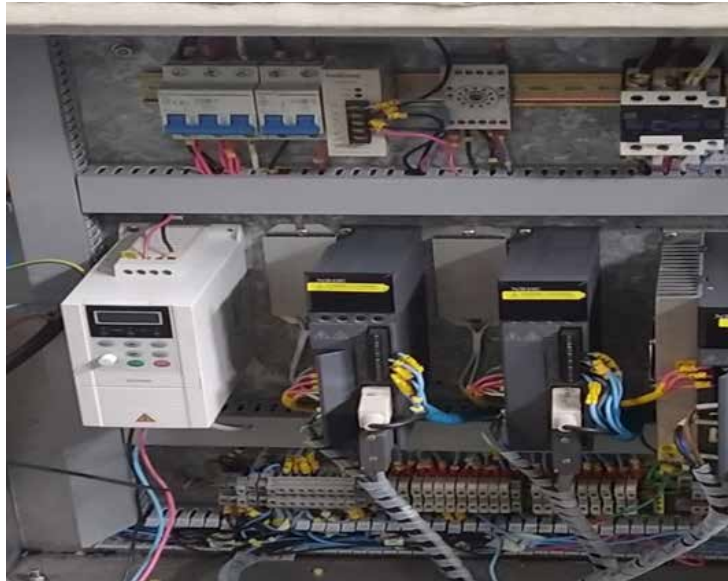
Figura 4. Panel de control eléctrico
