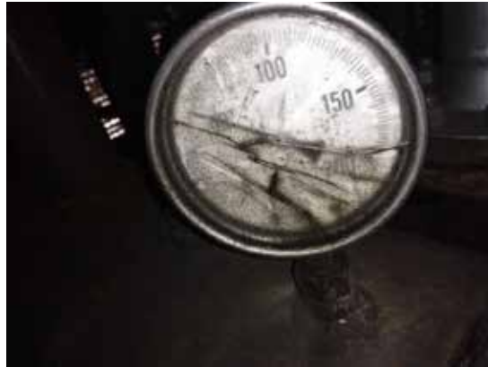
Figura 28 Manómetro principal de alta
