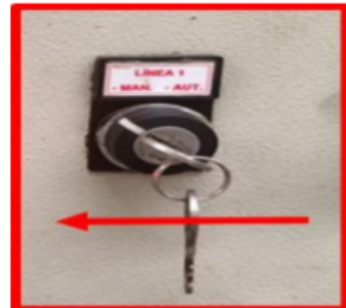
Imagen #4. Panel de control.
