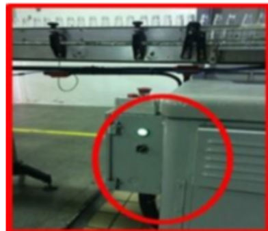
Imagen #2. Luz de aviso de falla.
