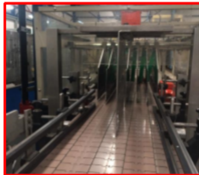
Imagen #1. Banda transportadora hacia separador.
