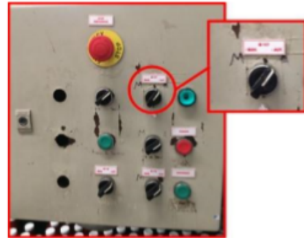
Imagen #6. Selector en dirección "AUT" para que el túnel accione automáticamente.
