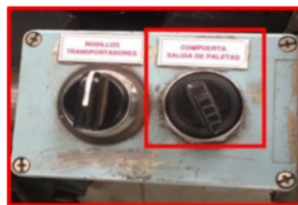
Imagen #14. Selector para abrir y/o cerrar compuerta.
