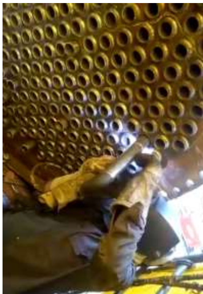
Figura 64: Intercambiador de calor con uniones soldadas por soldadura SMAW entre acero ASTM A36 y acero AISI 304
