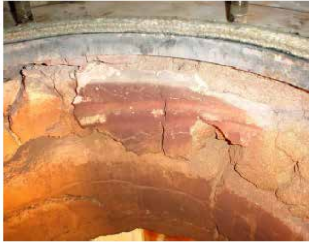
Figura 23 Rotura y desprendimiento de refractario por no respetar tiempos de secado refractario.
