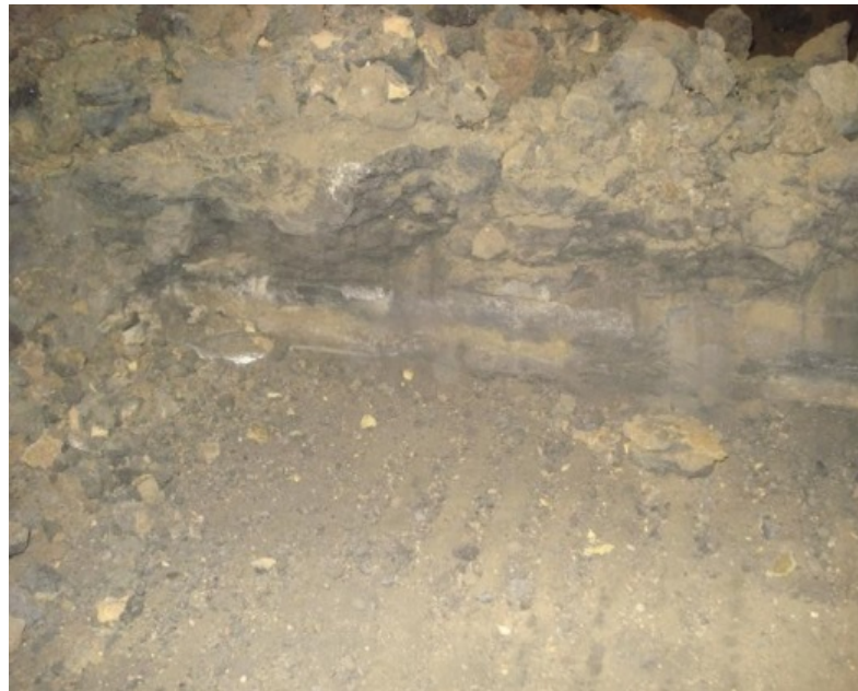
Figura 22 Vista de la escoria solidificada en el piso de la caldera.
