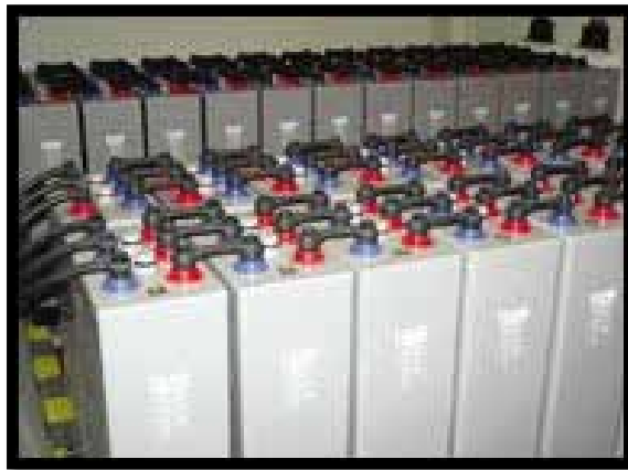
Figura 12: Banco de Baterías
