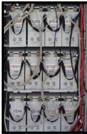
Figura 17: Sistema de Alimentación Ininterrumpida (SAI/UPS)
