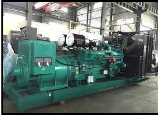
Figura 13: Grupo Electrónico (Motogenerador) Fuente: SHX SUNKINGS (2019)
