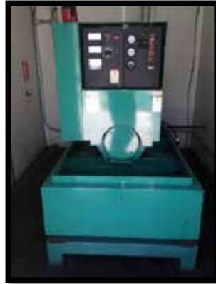
Figura 27: Motogenerador Detroit Diesel
