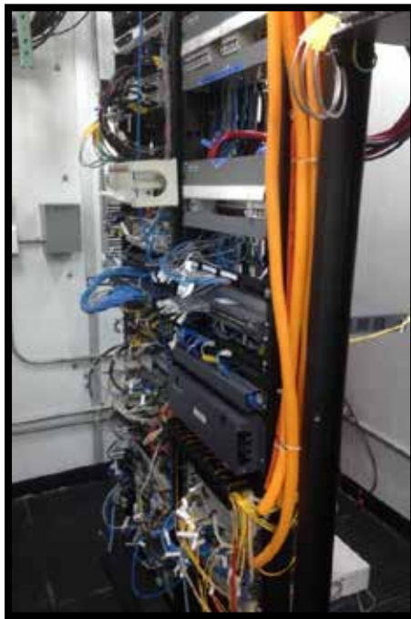
Figura 20: Racks 3 y 4 del Cuarto de Comunicaciones, estación Variante Norte
