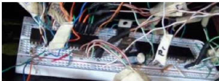
Figura 12. Módulo de control montado en Protoboard Fuente: Elaboración propia
