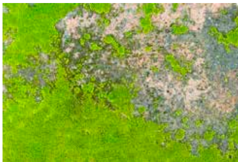
Figura 12. Muro de hormigón cubierto de hongos musgos y líquenes. Fuente: https://www.upc.edu.hormigon/biologico.com (2010)
