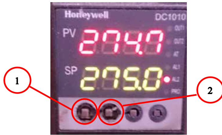
Figura 29: PLC controlador de la temperatura del horno
