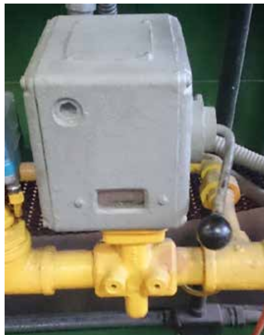
Figura 28: Regulador de Gas
