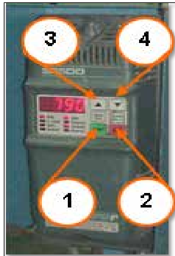
Figura 17: Tablero de control máquina plisadora
