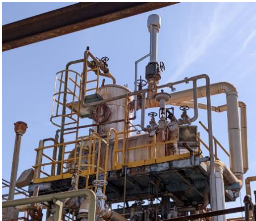
Figura 18: Zona de desaieramiento y precalentamiento de agua suavizada Fuente: Rosales, D. (2023)
