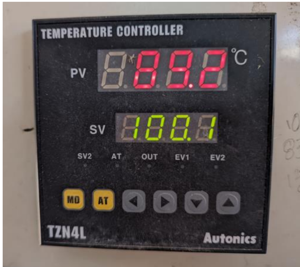
Figura 25: Panel Autonics para control de temperatura del agua de alimentación. Fuente: Rosales, D. (2023)
