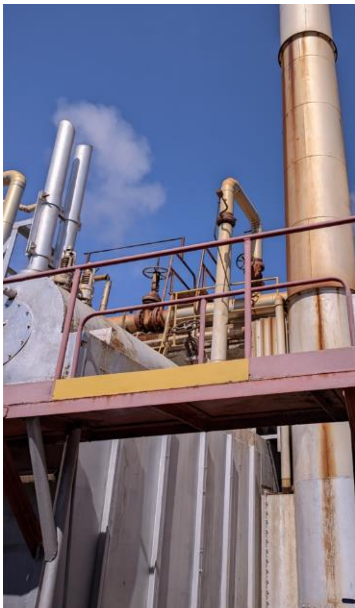
Figura 21: Chimenea de gases de escape de las calderas 1 y 2. Fuente: Rosales, D. (2023)
