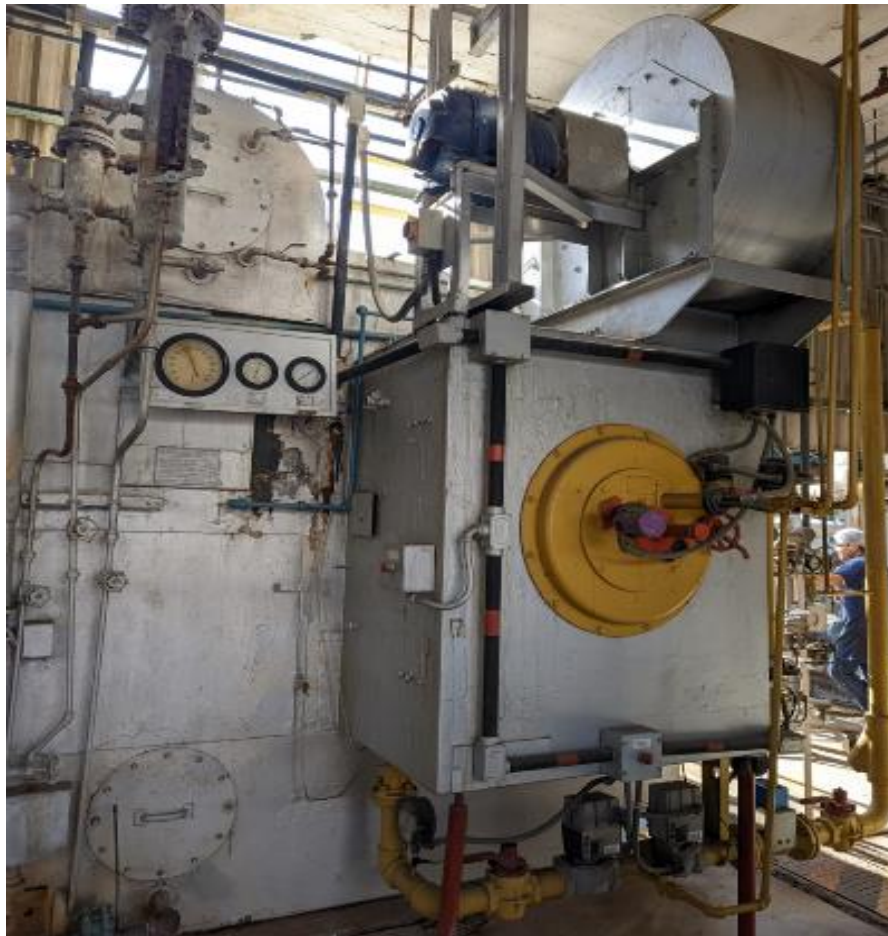
Figura 20: Caldera #1, domo inferior, superior y cámara de combustión Fuente: Rosales, D. (2023)
