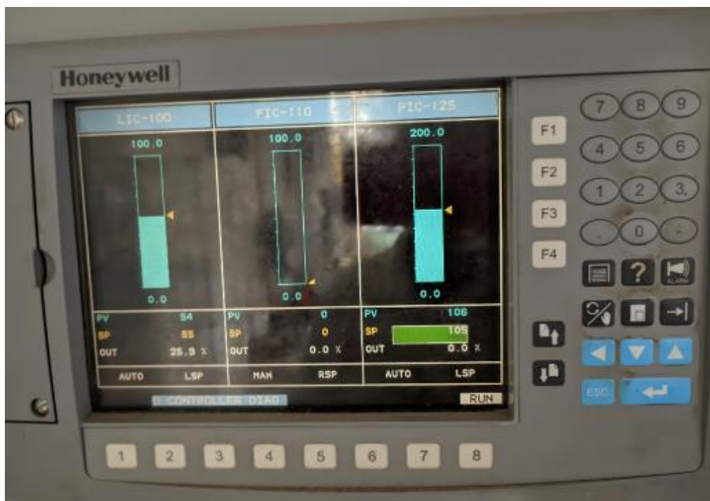
Figura 24: Monitor Honeywell para control de agua.
