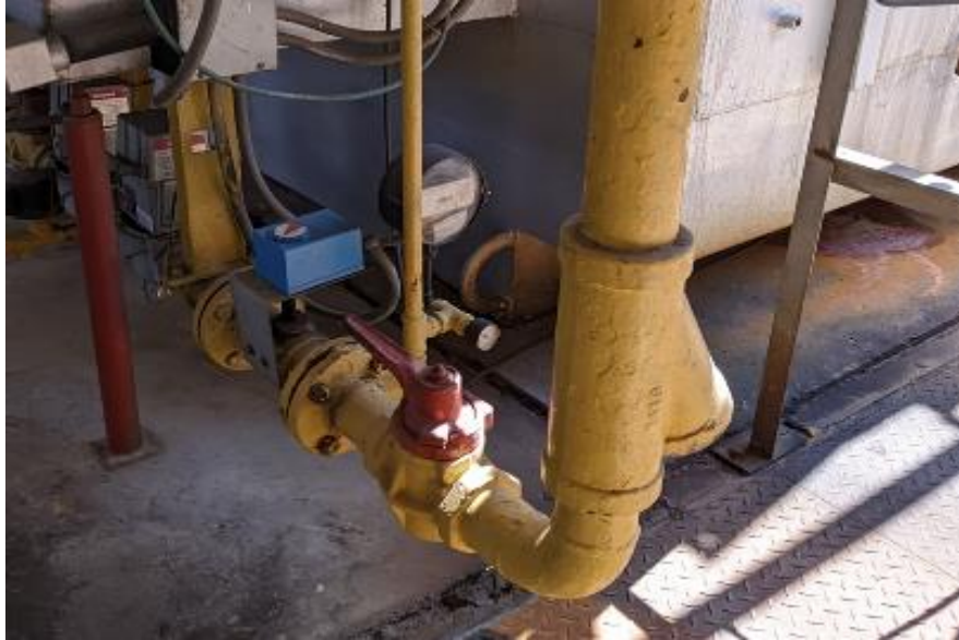
Figura 19: Suministro de gas para cada caldera Fuente: Rosales, D. (2023)
