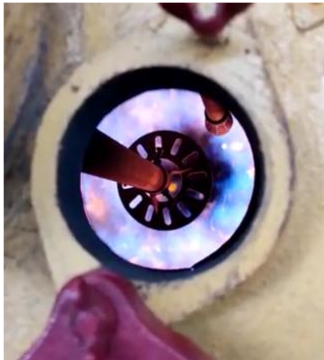
Figura 3: Interior del hogar de la caldera 2 Fuente: Rosales, D. (2023)
