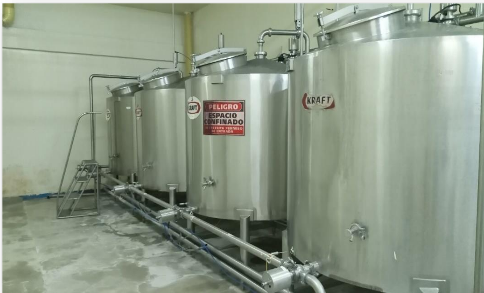
Figura n°5. Ilustración de Tanques de la línea de Mayonesa y llenado para CIP
