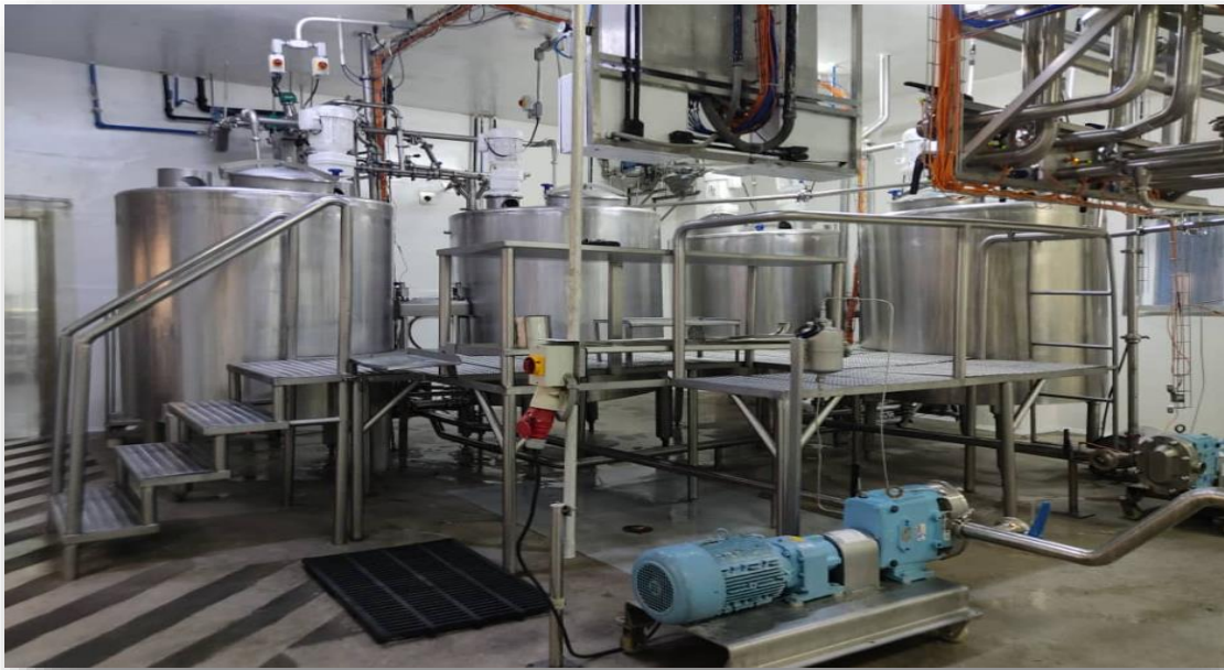
Figura n°22. Ilustración de 4 tanques Higienizados por el CIP (Tanques Premix)
