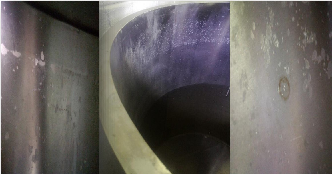
Figura n° 6. Ilustración de las evidencias de óxido y corrosiones en tanques de llenado de la línea de Mayonesa
