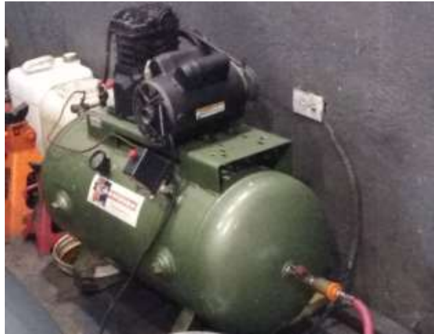
Figura 18: Compresor de Aire de la empresa Multiservicios Zuricars, C.A.
