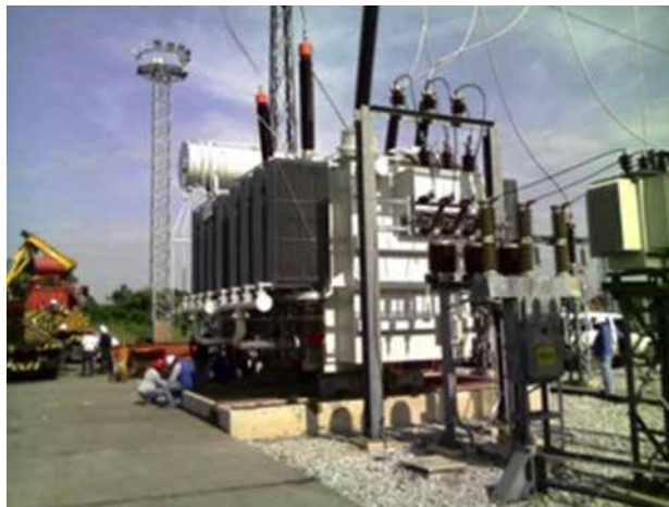
Figura N° 12 Sub-Estación en Páez
