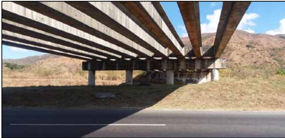
Figura 4. Estructura de la obra inconclusa del puente olvidado.
