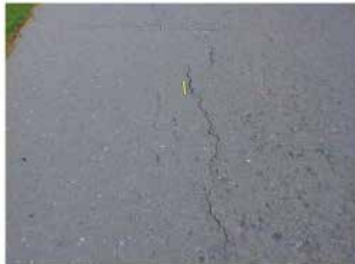
Figura 19: Ejemplo de las Grietas Transversales.
