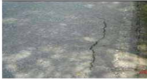
Figura 20: Ejemplo de Grietas de Contracción y/o Reflexión. Fuente: Miranda Rebolledo. Deterioros en Pavimentos Flexibles y Rígidos (pág. 18)
