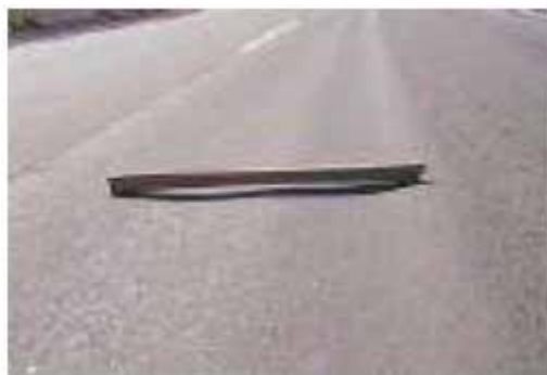
Figura 21: Ejemplo de Ahuellamiento. Fuente: Miranda Rebolledo. Deterioros en Pavimentos Flexibles y Rígidos (pág. 21)
