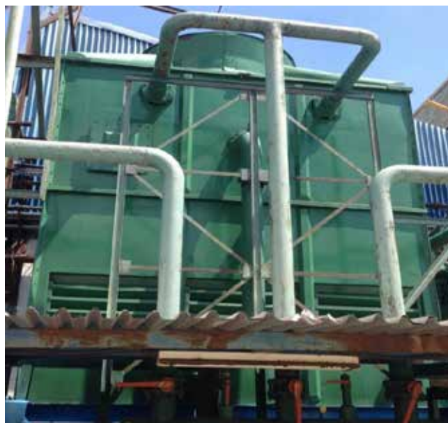
Figura 7. Torre de enfriamiento de mayor capacidad entre las de fibra de vidrio.
