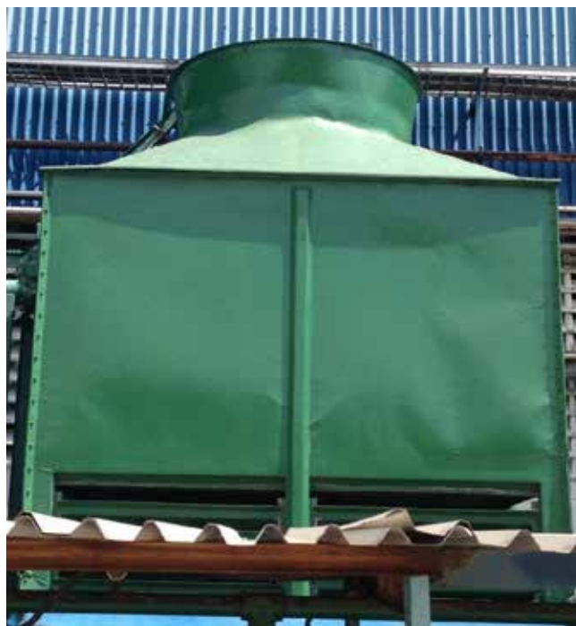
Figura 8. Torre de enfriamiento de fibra de vidrio de menor capacidad.
