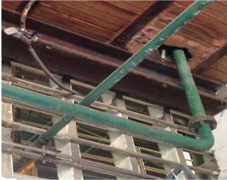
Figura 17. Deterioro en estructura de la zona de tratamiento de agua.
