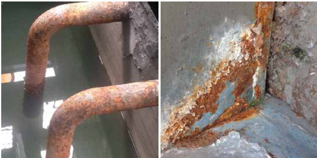
Figura 12. Corrosión microbiológica en tuberías sumergidas y concentradoras de humedad.
