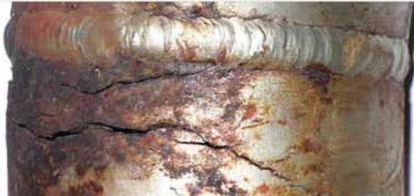
Figura 28. Ejemplo de corrosión con fractura por tensión.
