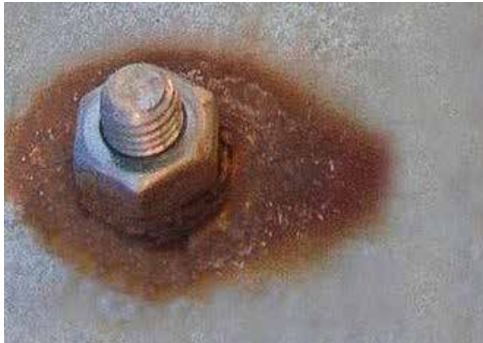
Figura 27. Ejemplo de corrosión galvánica.
