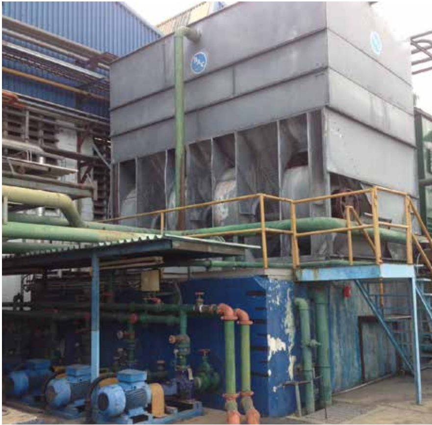
Figura 10. Torre de enfriamiento marca Baltimore de Alcave planta Conal.
