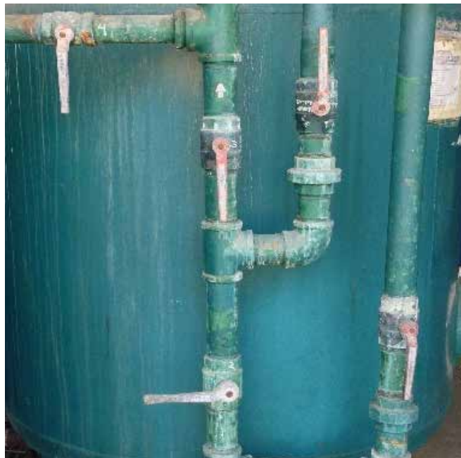
Figura 18. Válvulas de cierre rápido oxidadas.
