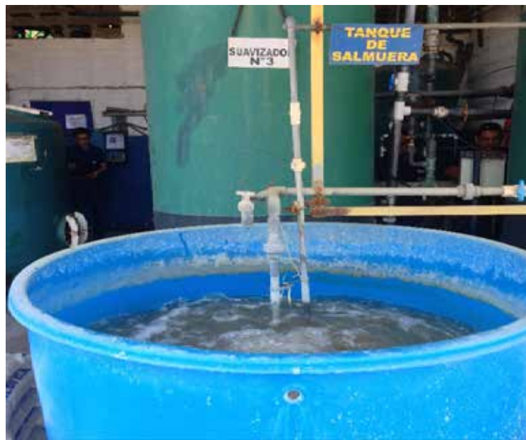
Figura 16. Tanque de salmuera destapado.
