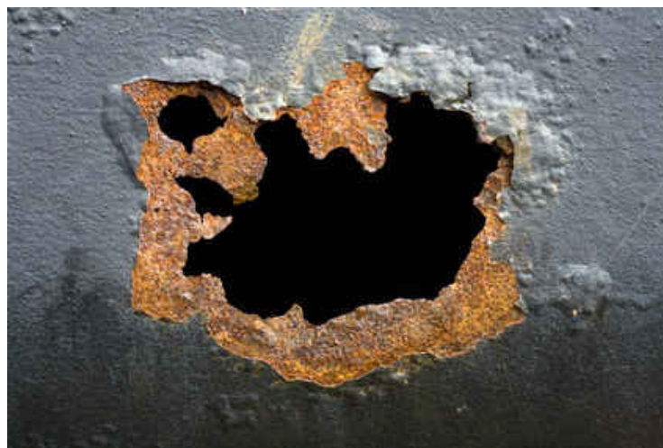
Figura 26. Ejemplo de corrosión por picadura.
