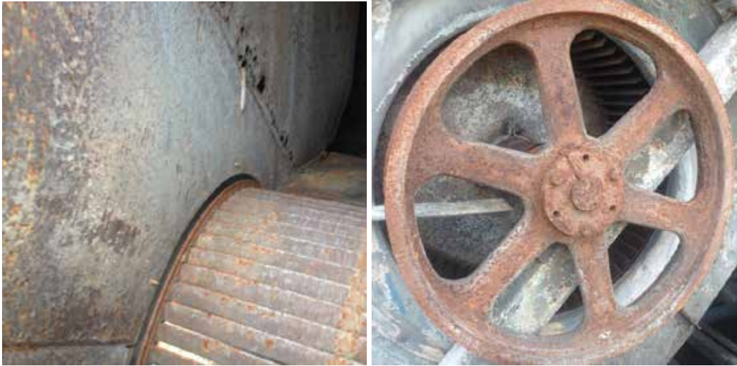
Figura 11. Corrosión por picadura en paneles, turbinas y poleas.
