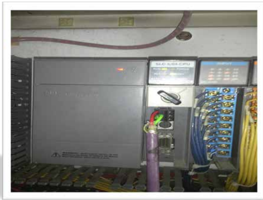
Figura 8. PLC SLC 5/04 Allen-Bradley con comunicación Data High plus ubicado en un tablero de control de Cargill, S.R.L Planta Valencia.
