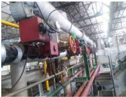
Vista lateral de las válvulas principales agua y soda
