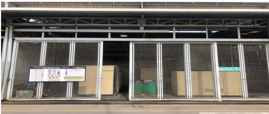
Figura 1: Sala compresores ACUMULADORES DUNCAN C.A.
